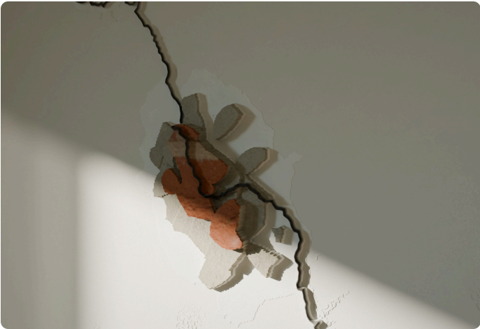
Foto 1.2 · Detalle de la fisura y el desprendimiento de pañete. Diseño de referencia.
